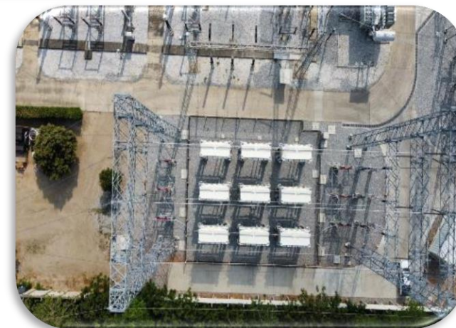
Fotos: ISA Transelca – Projeto Santa Marta 220 kV – Colômbia.
